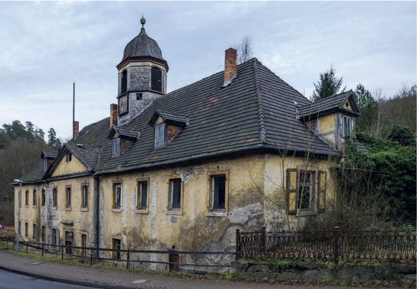
Aus dem 18. Jahrhundert stammt dieses Verwaltungsgebäude einer Eisenhütte im Harz, das langsam aber sicher verfällt. ISO 200 | Brennweite 25 mm | Blende f/9 | Verschlusszeit 1/40 s
